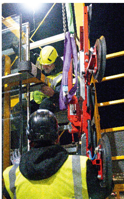
Bei der Demontage und dem Einbau der neuen Fenster kamen spezielle Glas-Sauganlagen zum Einsatz.
