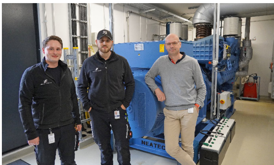
Hans-Gerd Thormeier (re.) und seine Mitarbeiter Leo Hilbers und Leon Marciniak vor einer der zwei neuen Netzersatzanlagen. Fotos: Anja Naumann
