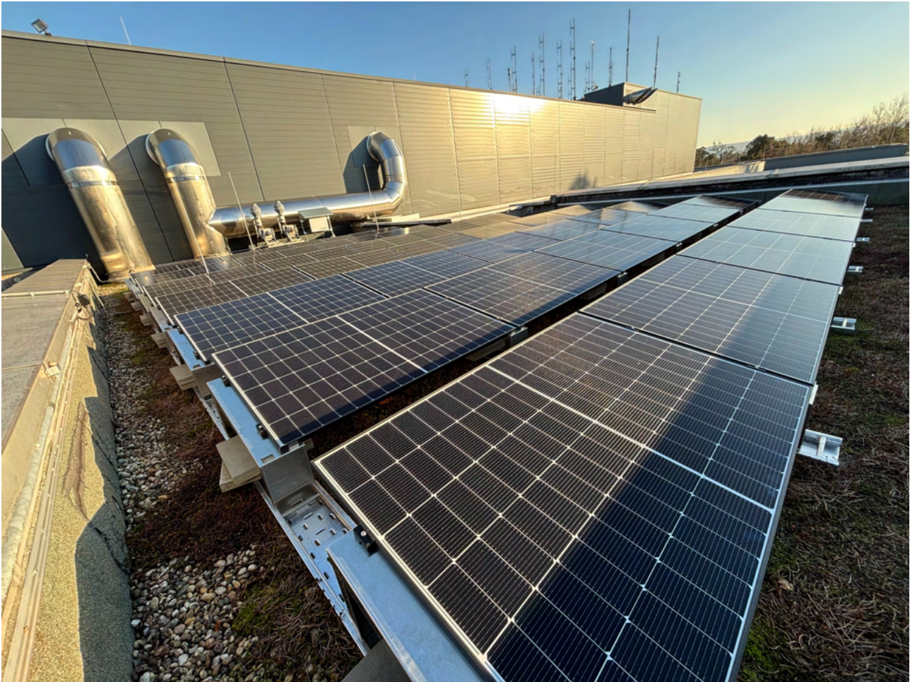
Auf den Dächern ihrer Gebäude installiert die DFS nach und nach eigene Photovoltaik-Anlagen - wie hier am Standort Karlsruhe. (Foto: DFS)
