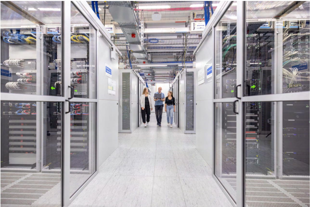
Durch das Kaltgang-/Warmgangkonzept werden nur die Server gekühlt und nicht der ganze Raum. (Foto: DFS)
