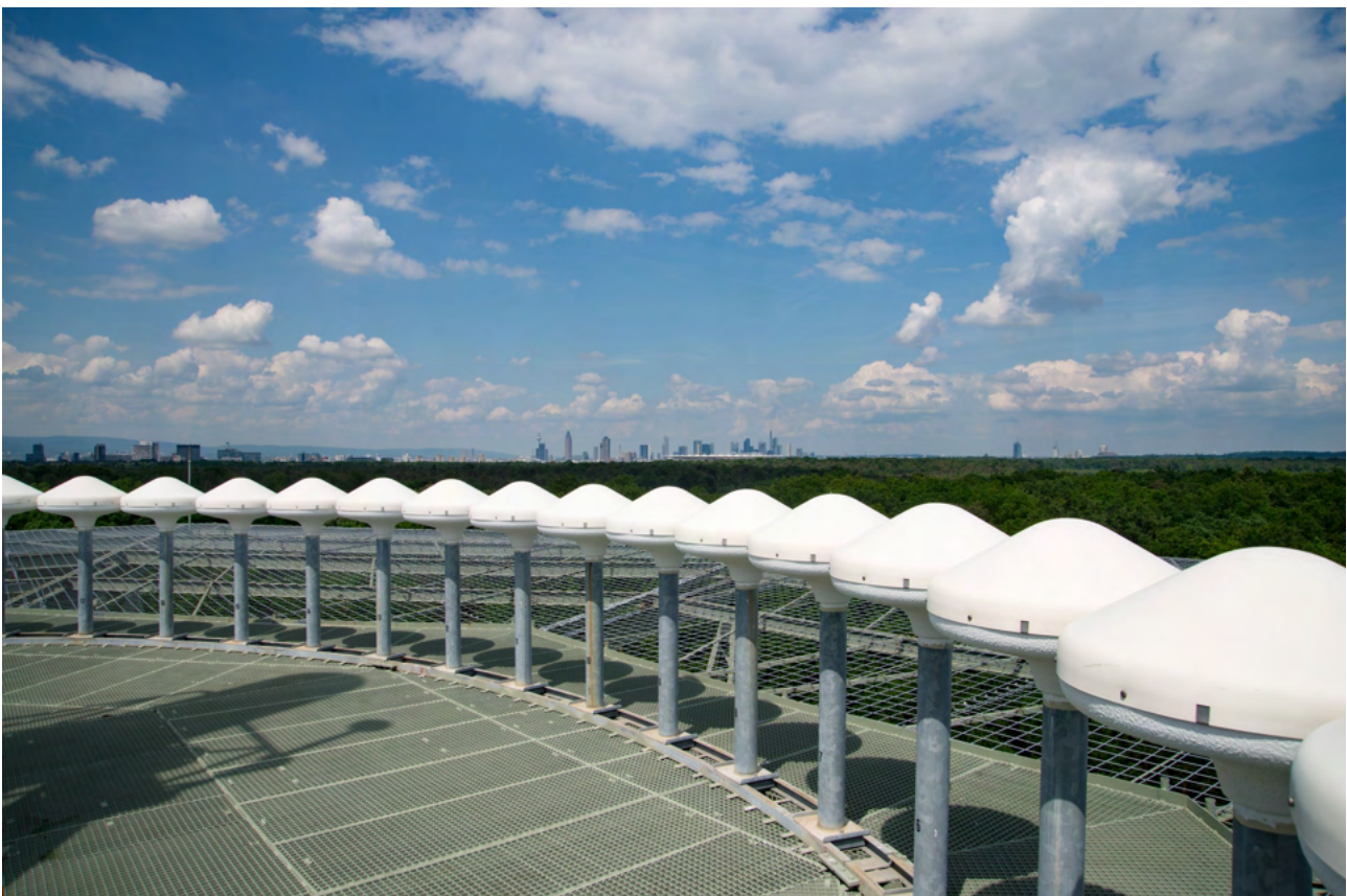
Doppler-VORs wie diese Anlage in der Nähe von Frankfurt sind widerstandsfähiger gegen Störsignale und wesentlich energieeffizienter als konventionelle Drehfunkfeuer. (Foto: DFS)
