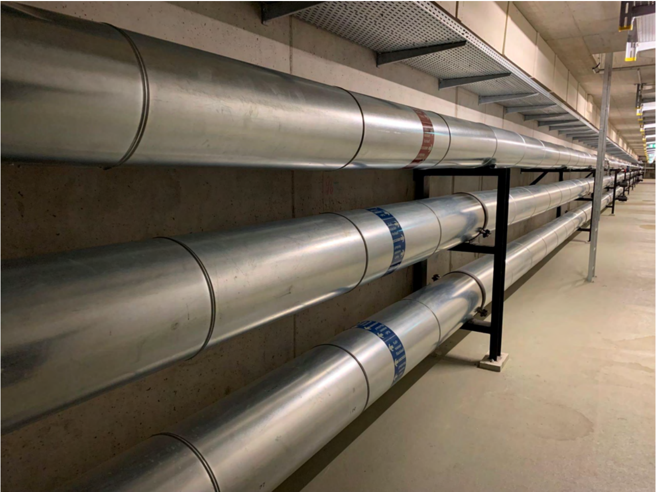
Über eigene Medienkanäle versorgt die DFS Energy alle Gebäude der DFS sowie anliegender Behörden mit Strom, Wärme, Kälte und Dampf. (Foto: DFS)
