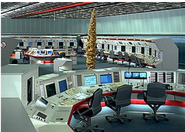
Abbildung 1: Blick in eine Kontrollzentrale mit P1 System
